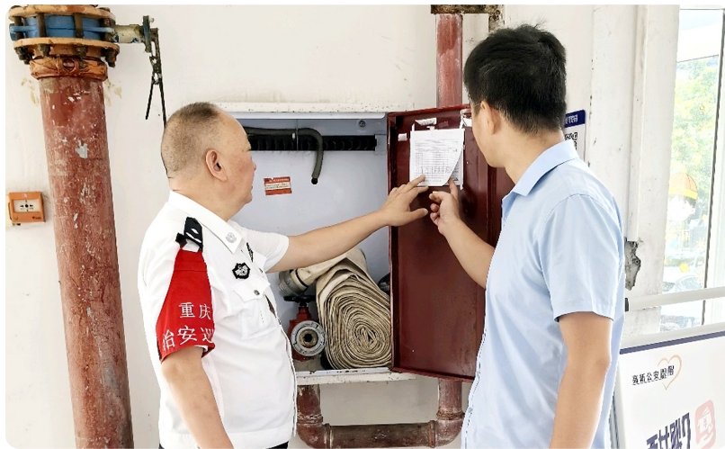
▲万云华检查消防设施
